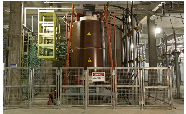
HiDry 72 69 kV/25 MVA Trockentransformator, installiert im Untergeschoss des Fussballstadions von Salvador da Bahia, Brasilien, wo 2014 mehrere Weltmeisterschaftsspiele stattfanden (Traföhöhe >5 m).
